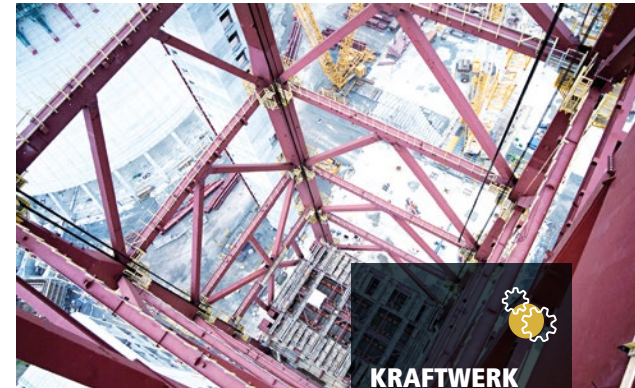
KRAFTWERK DATTeln, BLOCK 4
